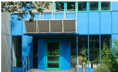
Vorher Ausgebleichte Fassade
